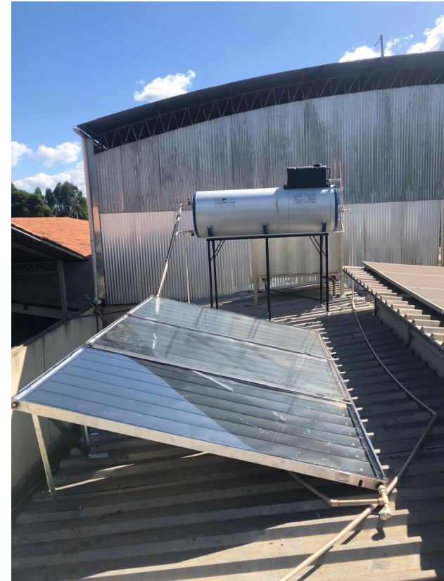
Sistema de aquecimento solar
