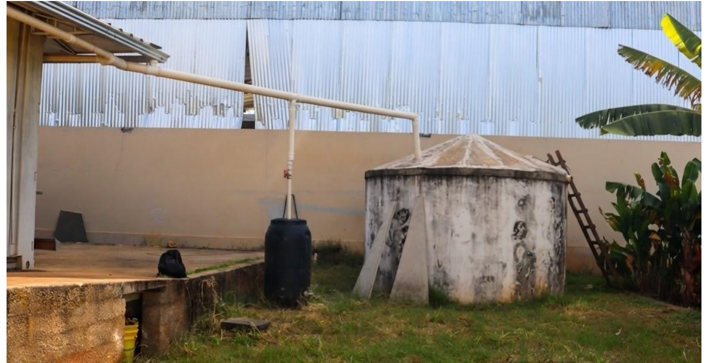
Sistema de coleta e armazenamento de águas pluviais
