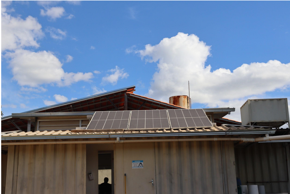
Sistema de energia fotovoltaica
